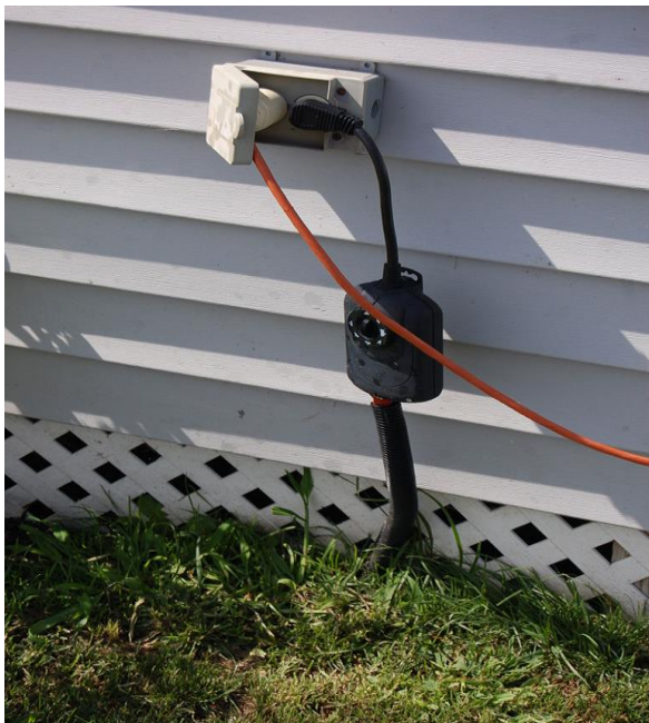
Figura 1. Instalación de un tomacorriente en un lugar a la intemperie.
