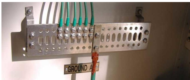
Figura 1. La puesta a tierra es más que una simple conexión de un sistema eléctrico a la tierra física de la edificación.
